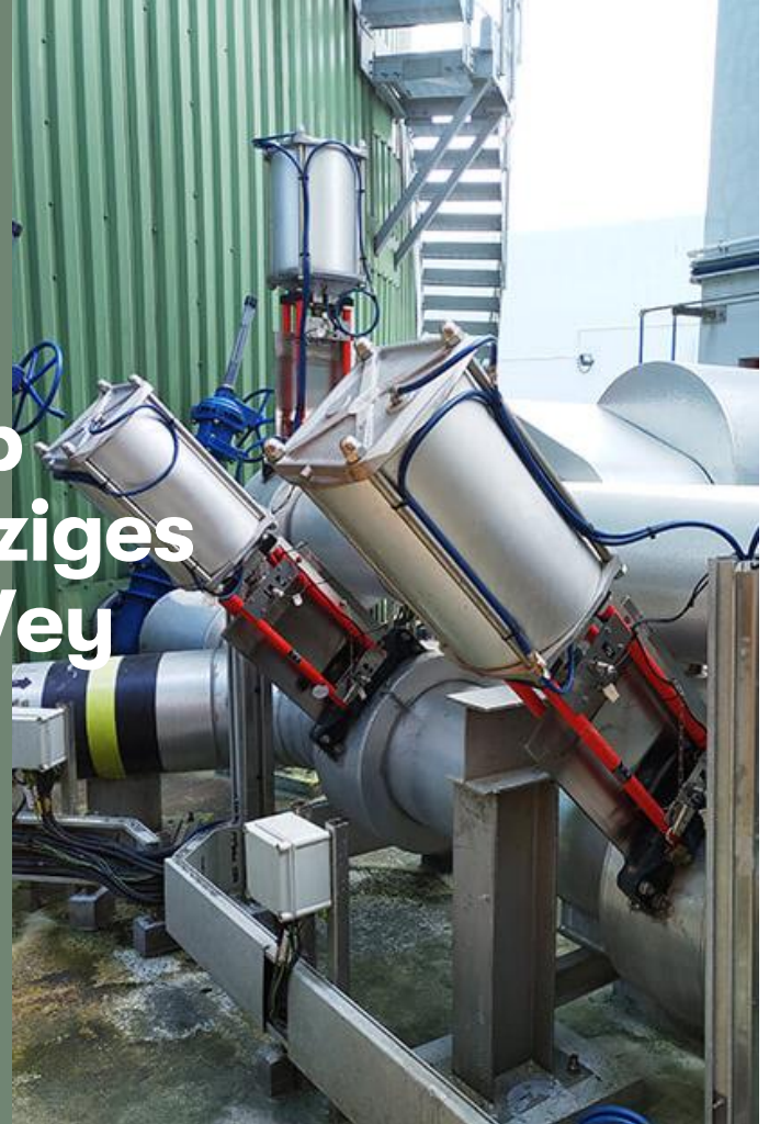
Wey Plattenschieber MFC DN 300 im Aussenbereich der Anlage.
