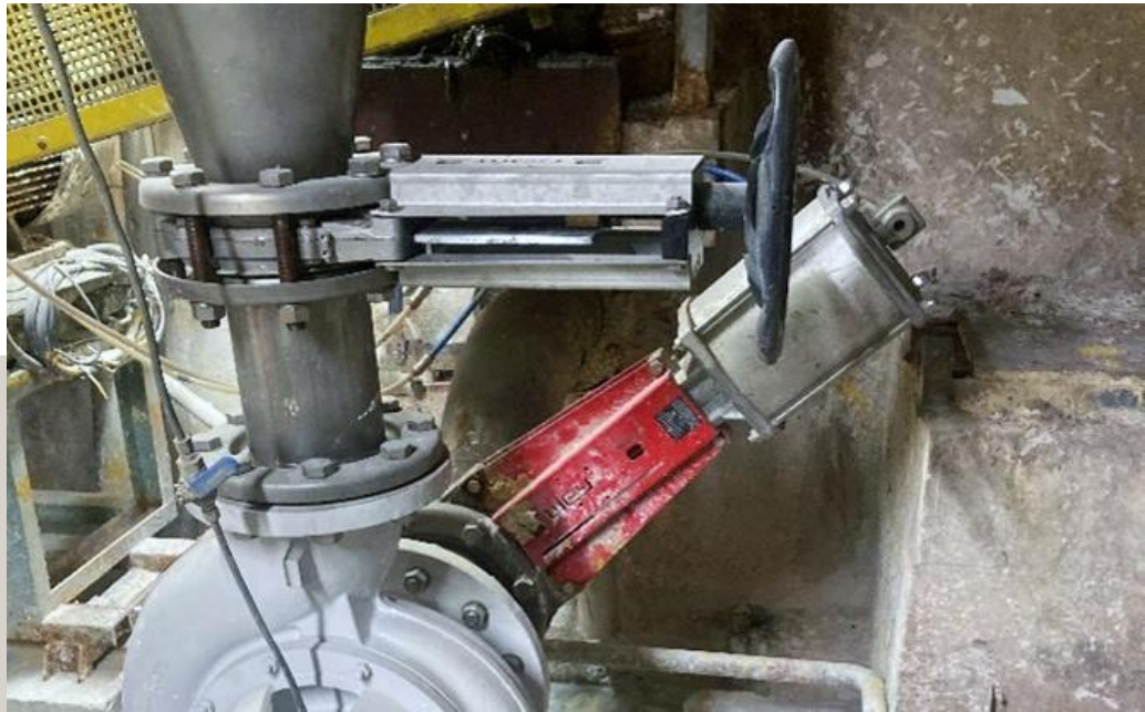
Manuell und pneumatisch betriebene Wey Plattenschieber VN an den Zellstoffpumpen
