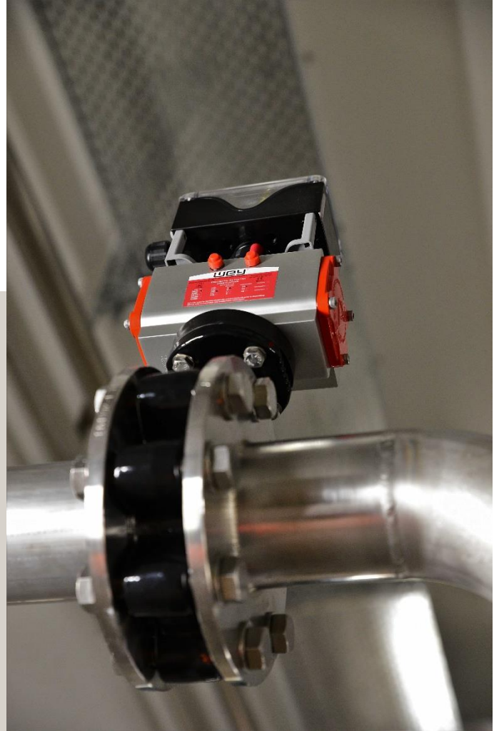
Wey Absperrklappe TL20 in der Druckluftversorgung der neuen Anlage.
